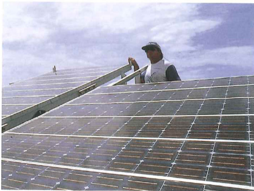
Solceller anvendt som energikilde for vandpumper i Namibia.
