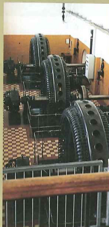
Generators på et lille elværk i Danmark.
